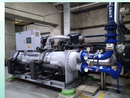
空調設備磁浮冰水主機
