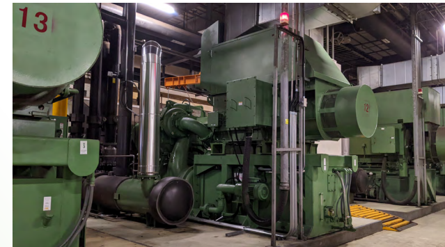
空壓機節電改善_新增高效率空壓機
