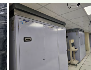
增設回風管避免空調冷送風直接回風短循環
