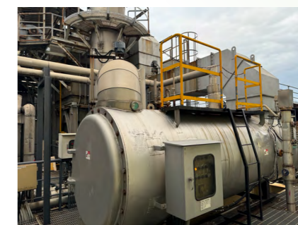
RTO 廢熱鍋爐瓦斯系統節能效益 - RTO+ 廢熱鍋爐
